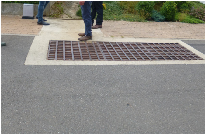
Grille avec bassin de rétention - rue Maubille
