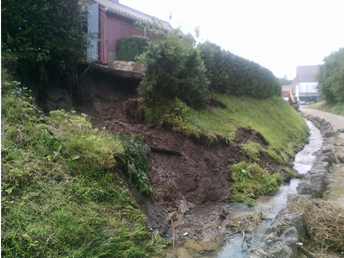
Talus détaché sur la rue du Palais en juin 2017
