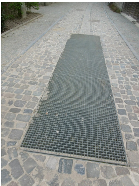
Bassin de rétention - chemin des Saules
